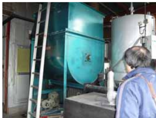
写真2 バイオマスボイラー（飯山市）
